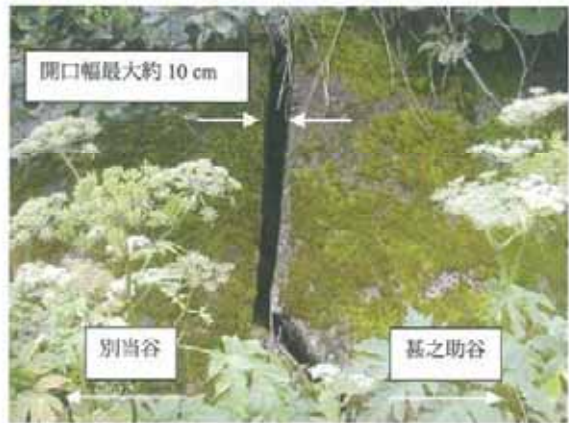
図-11 上部ブロックと下部ブロックの境界 (図-10, F点) における擁壁のクラック (2003年9月3日著者撮影)
