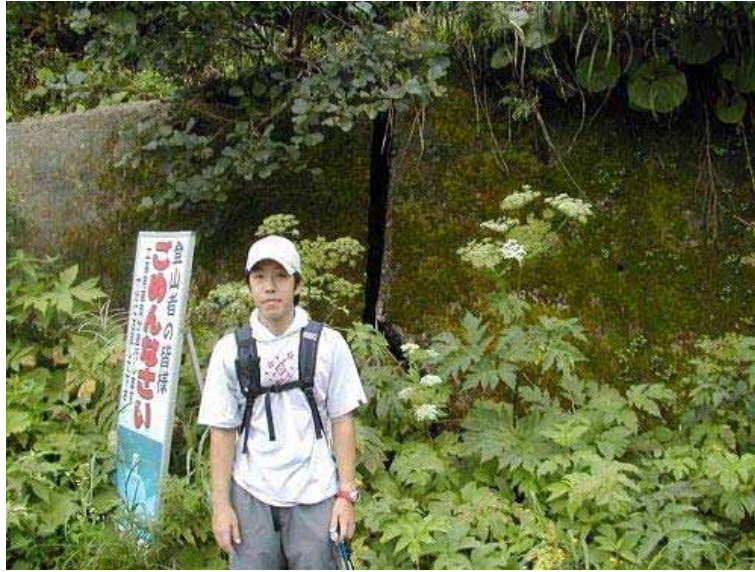
図 3.4 標高 1650m 付近コンクリート擁壁のクラック (2003 年 9 月 29 日撮影)
