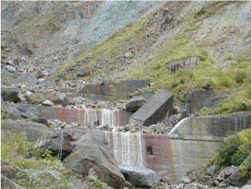
図 3.6 甚之助谷側の崩壊した砂防堰堤 (2002 年 9 月 3 日撮影)
