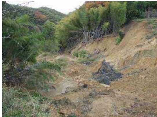
頭部から地すべり内部を見る。かなりの量の土砂が流出していることがわかるが、未だ10 m程度の層厚の土砂が残留している。
