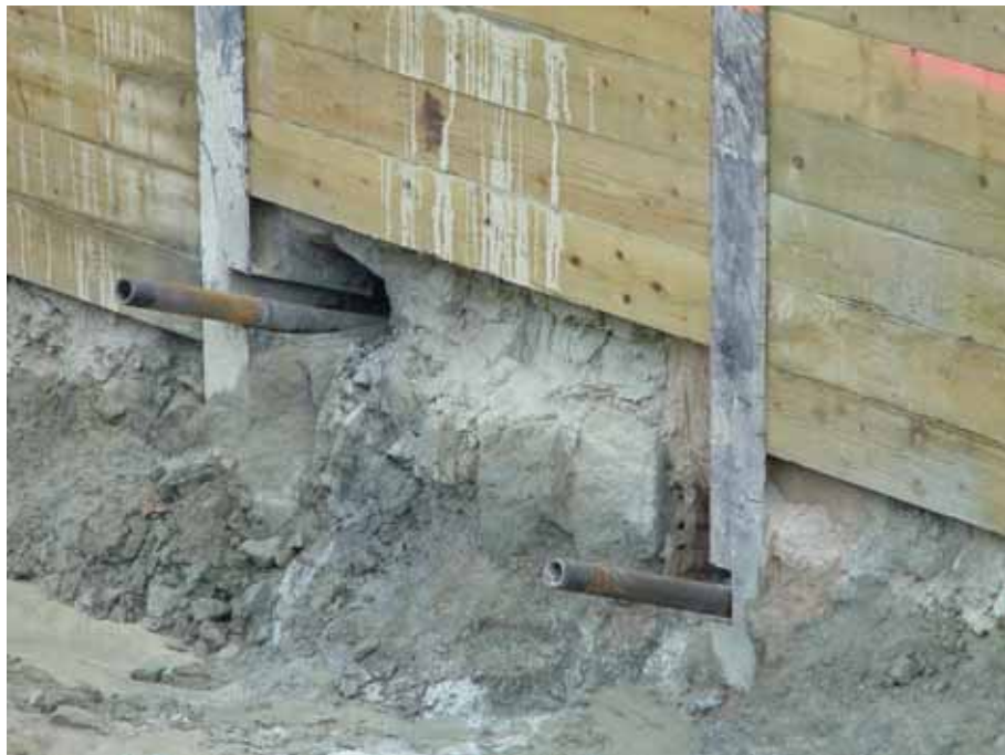
図 17 Bluebird Canyon 地すべり末端部での留めアンカー - 抑制杭システムのアンカー頭部と H 鋼の接合部分
