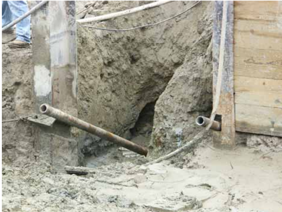
図 16 留めアンカー - 抑制杭システムのアンカー頭部状況
