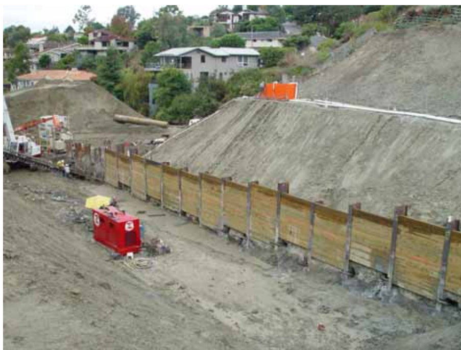
図 15 Bluebird Canyon 地すべり末端部での留めアンカー - 抑制杭システム，アンカー頭部の固定は未完成である
