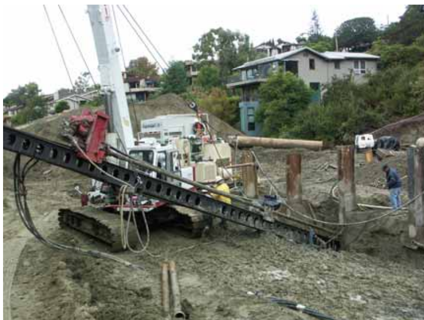
図 14 Bluebird Canyon 地すべり末端部でのアンカー設置現場作業状況（H 鋼の壁は先に設置完了している）
